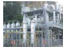
中型水素発生設備
