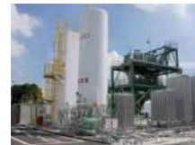
高純度メタン製造装置
