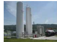
LNGサテライト基地
