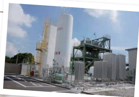
新設された「高純度メタン製造設備」（横浜）
