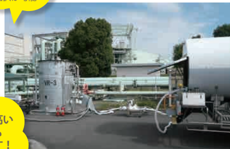
LNG タンクのガスパーuzzi
